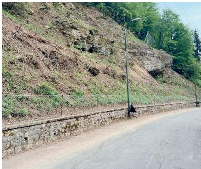
Dissesto. Reti di protezione a margine della strada
